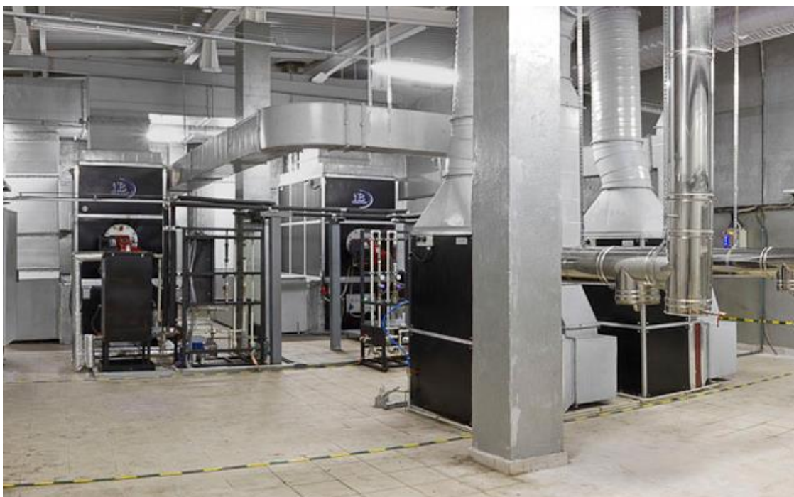
Теплогенераторная, работающая на водозмульсионном топливе
